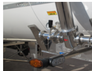
FIGURA 22: Colector de presión con filtro
