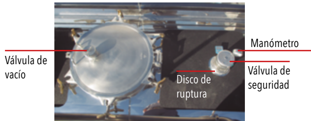
FIGURA 35: Válvula vacío + válvula seguridad + disco de ruptura
